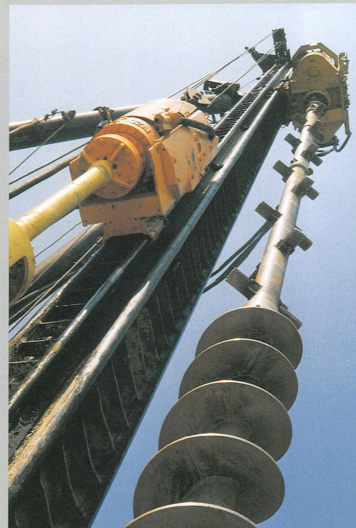
堀削攪拌シャフト
