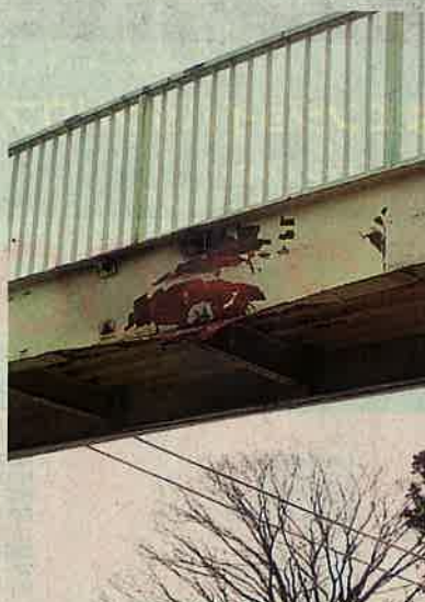
損傷した歩道橋—北杜市白州町下教来石(国土交通省甲府河川国道事務所提供)
