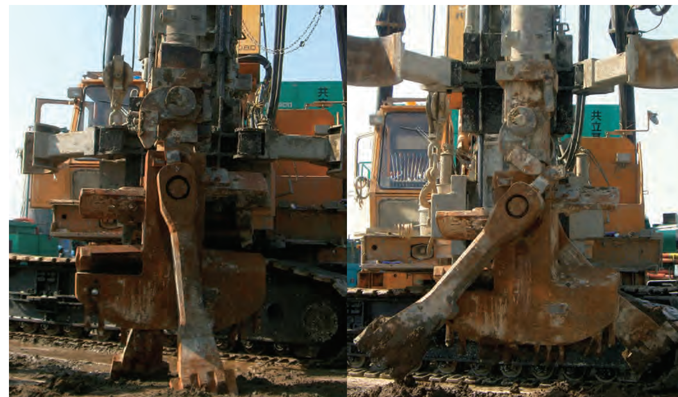
※拡大掘削径管理装置例
